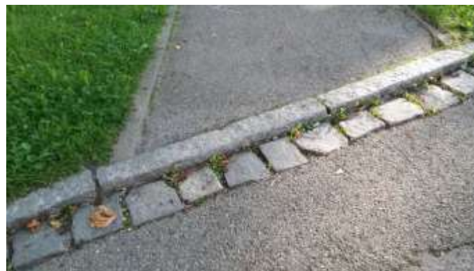
Gehweg schräg zur Ampelanlage, Bordstein ca. 4 cm hoch
