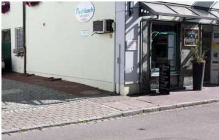
Absatz Fußgängerweg-Straße zu hoch
